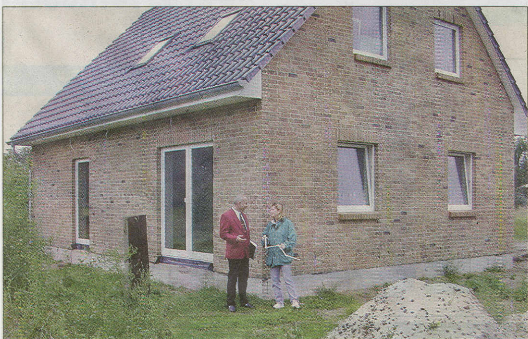
Dieses schucke verlinkerte Häuschen wird in Mützel gebaut. Werner Schönemann im Gespräch mit der Bauherrin. Fotos: Monika Lück# (2)
